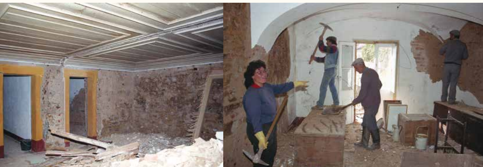
Obras de adaptação do edifício contíguo à Casa Grande a Biblioteca Municipal - 1991
